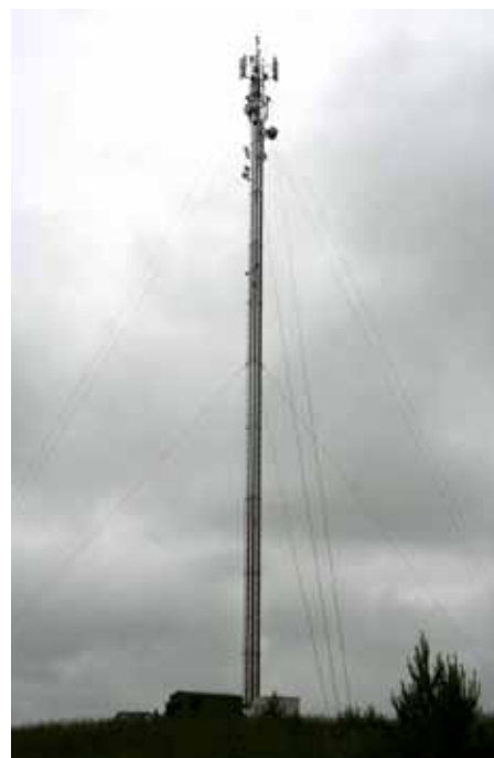
Gaisrų stebėjimo sistemų kameros įrengtos ant kai kurių telekomunikacijos bokštų
