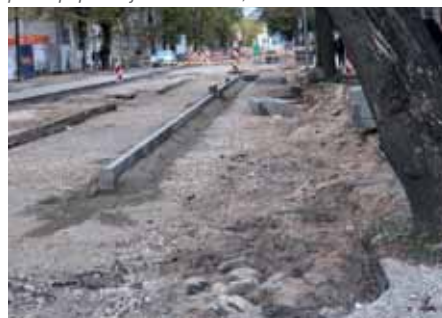
Cementas, skalda – gatvėje, vėliau asfaltas. Užblokuotos medžių šaknys
